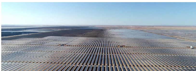
图 4.2-3 埃及的本班光伏产业园 ①
